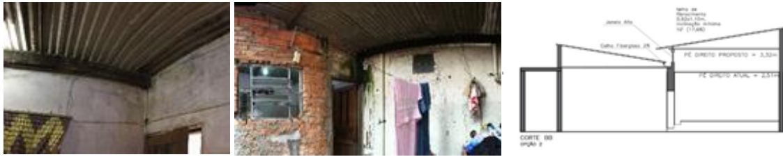
Figura 2. A esquerda, local de junção dos telhados, parede com mofo. Ao centro, a visualização da entrada, parede e porta comprometidas com mofo. A direita, um corte longitudinal representando a janela, posicionamento do telhado e a calha.
