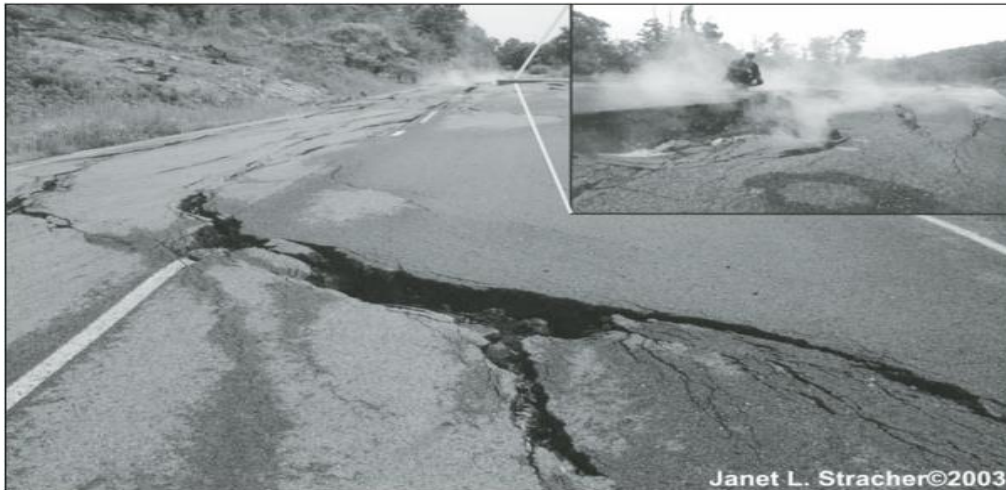
FIGURA 2. Trecho da Rota 61 interditado após comprometimento de sua estrutura pelo incêndio. Fonte: STRACHER et al. , 2006.
