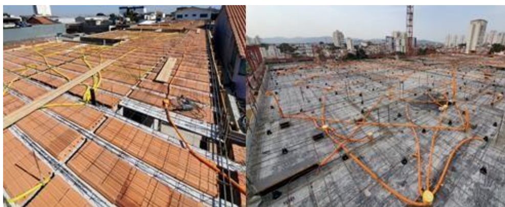
Figura 3. Diferença entre laje pré-moldada e moldada in loco para as obras 1 e 2, respectivamente.
