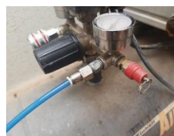
Figura 10 – Saída do compressor e encanamento 6mm. Fonte: Próprio autor.
