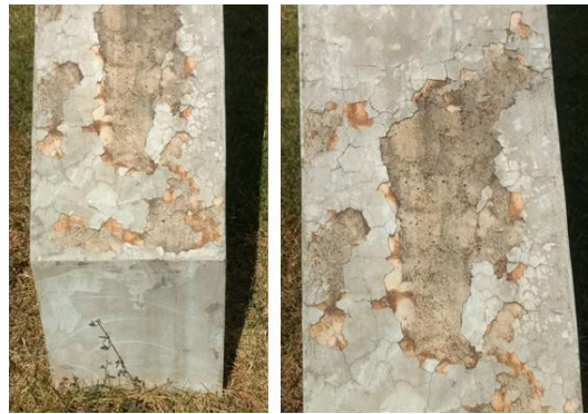
FIGURA 3. Deslocamento/craquelção de estucamento de regiões expostas a intempéries.
