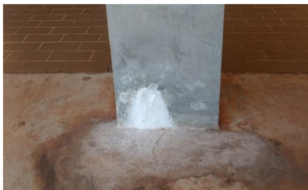
FIGURA 5. Eflorescência presente na base de um dos pórticos da estrutura.
