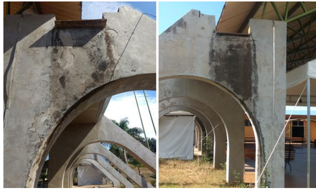
FIGURA 2. Presença de bolor ou fungos e deslocamento/craquelção do estucamento.
