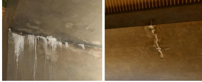
FIGURA 1. Formação de eflorescência na parte inferior da calha de concreto.
