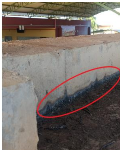
FIGURA 4. Destaque do local da possível infiltração e da formação de lodo devido falha no escoamento de água da chuva.
